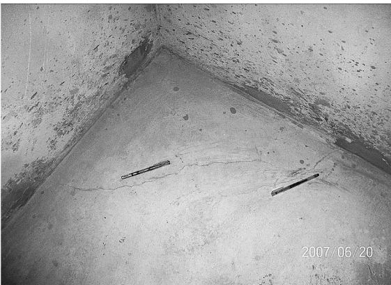
图2 照片9层西南角板面裂缝
