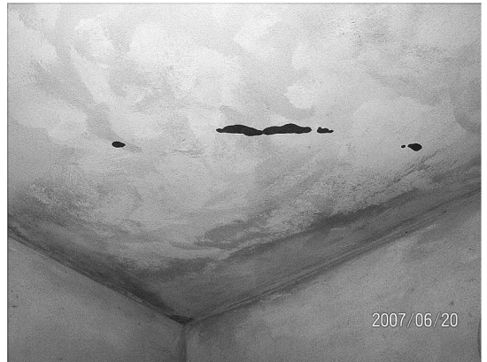
图3 照片9层西南角板底裂缝
